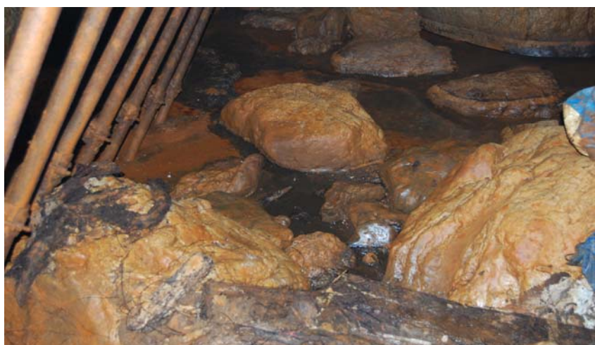
danni prodotti dall'ossidazione delle impalcature lasciate oltre la diga
